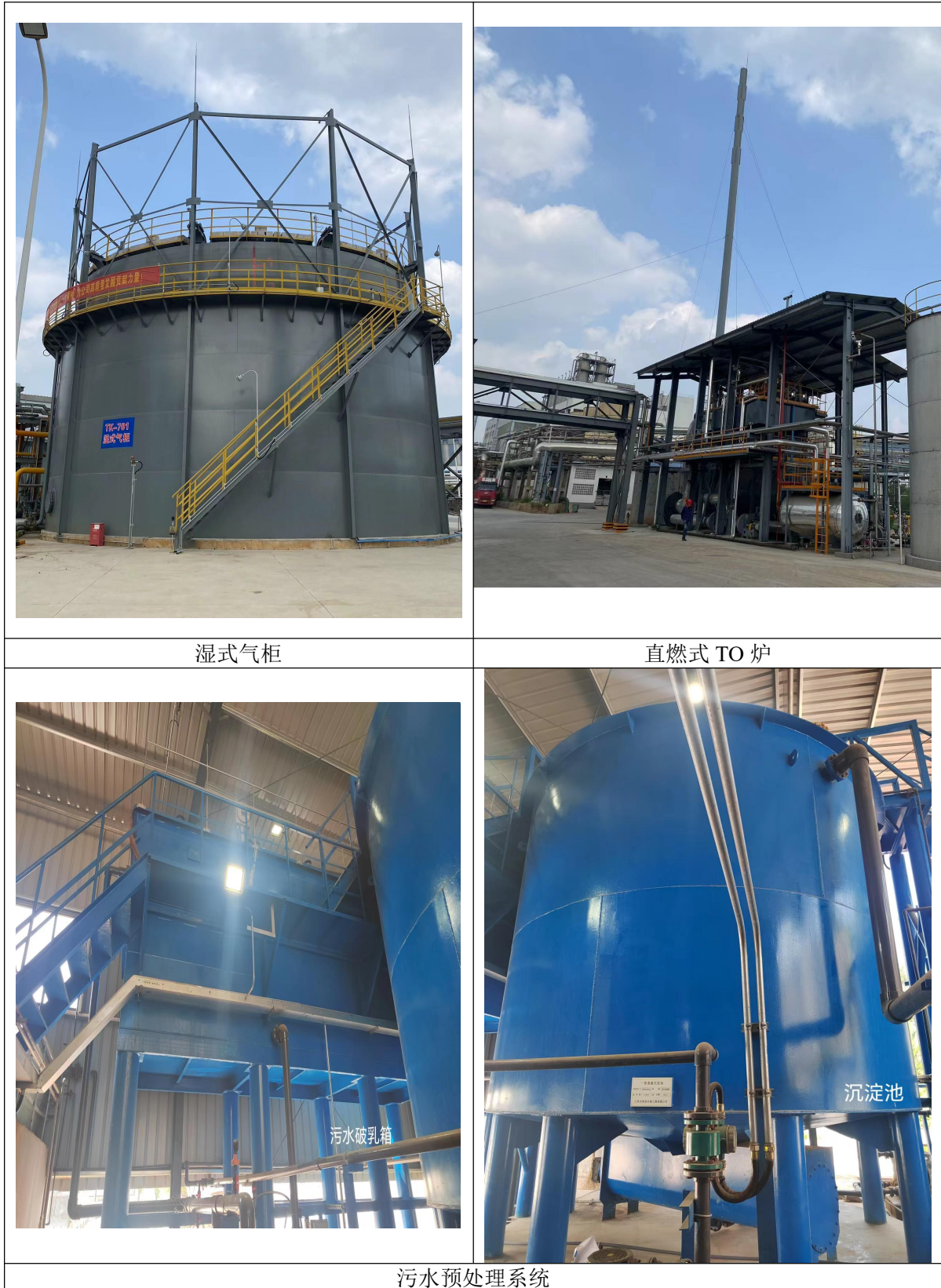
图 3 本项目已采取的主要废气及废水治理设施现场图片
