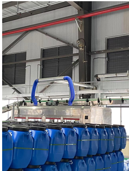
灌装线废气收集管线
