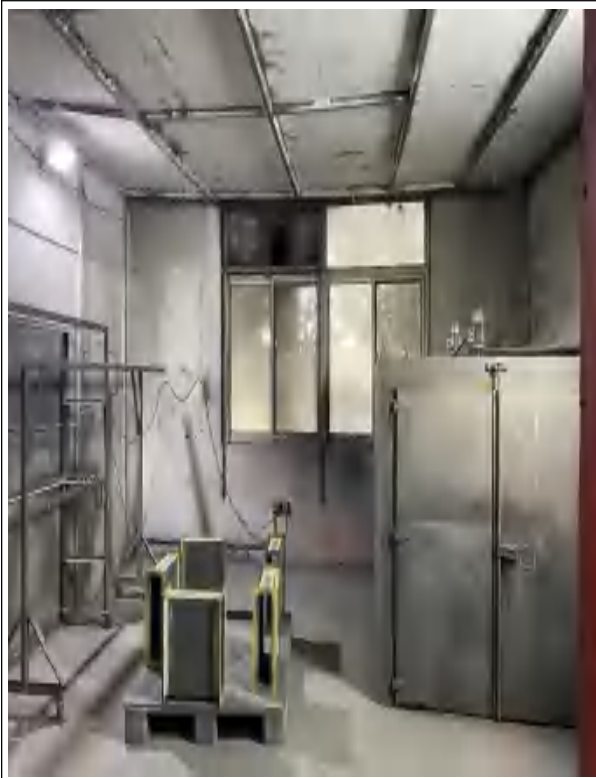
封闭式喷涂房
