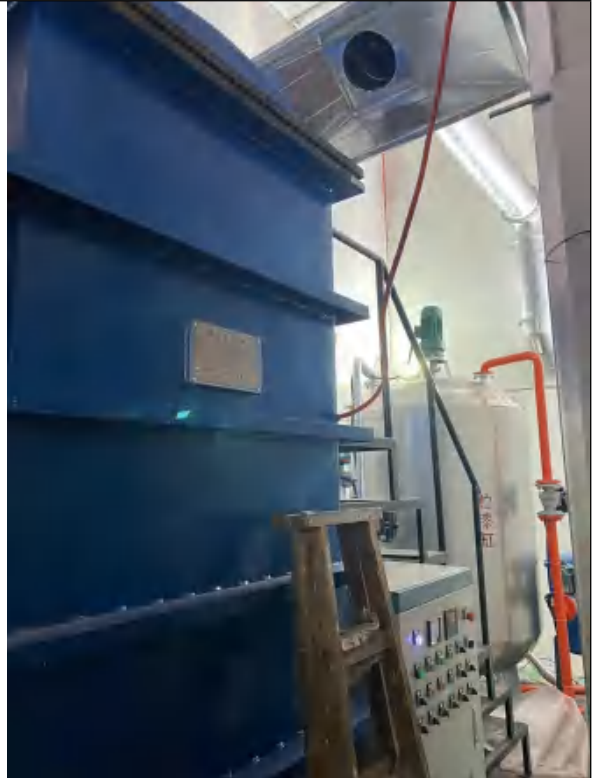
封闭式浸漆房
